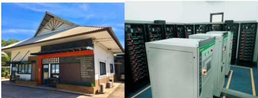
รูปที่ 4 ระบบกักเก็บพลังงานที่ติดตั้ง ณ อาคารสำนักงานอาคารสถานที่และยานพาหนะ
