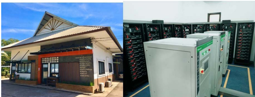
รูปที่ 4 ระบบกักเก็บพลังงานที่ติดตั้ง ณ อาคารสำนักงานอาคารสถานที่และยานพาหนะ
